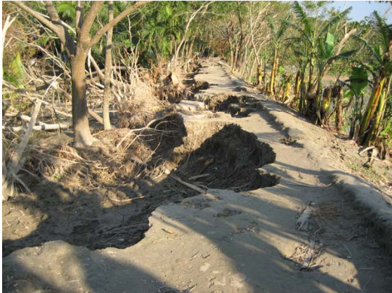
Digue endommagée en 2007 prête à céder (photo © D. Swanson /IRIN 2007120
